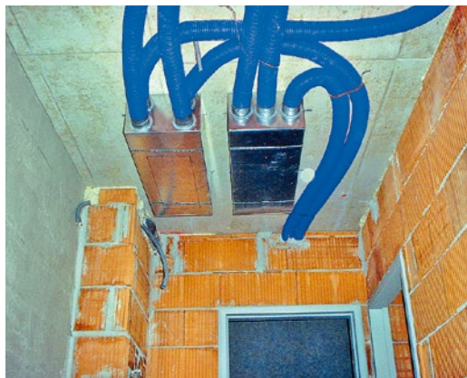
Detail zakázkových rozdělovačů EDF-M-BOX v suterénu budovy
