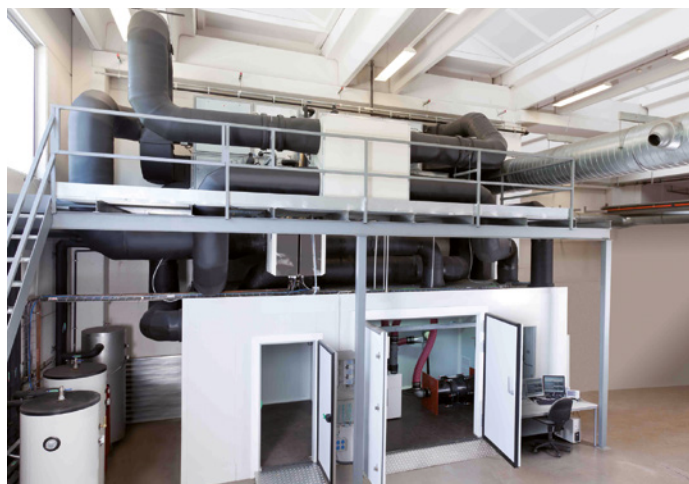
Klimatická komora pro testování rekuperačních jednotek
